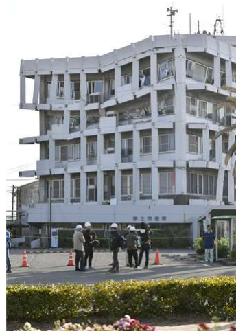
地震後の宇土市役所
