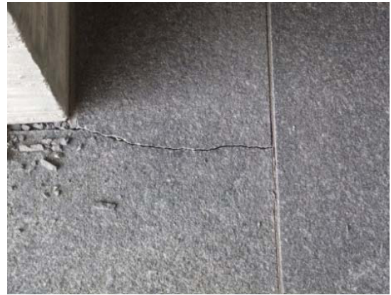
校内に生じた亀裂
