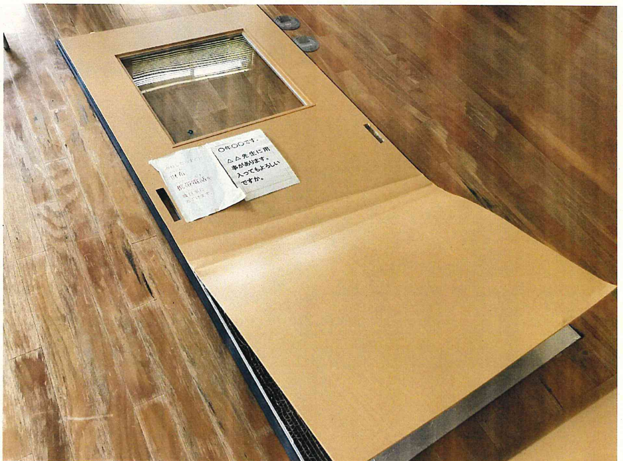
木床、木壁内部にカビ発生
