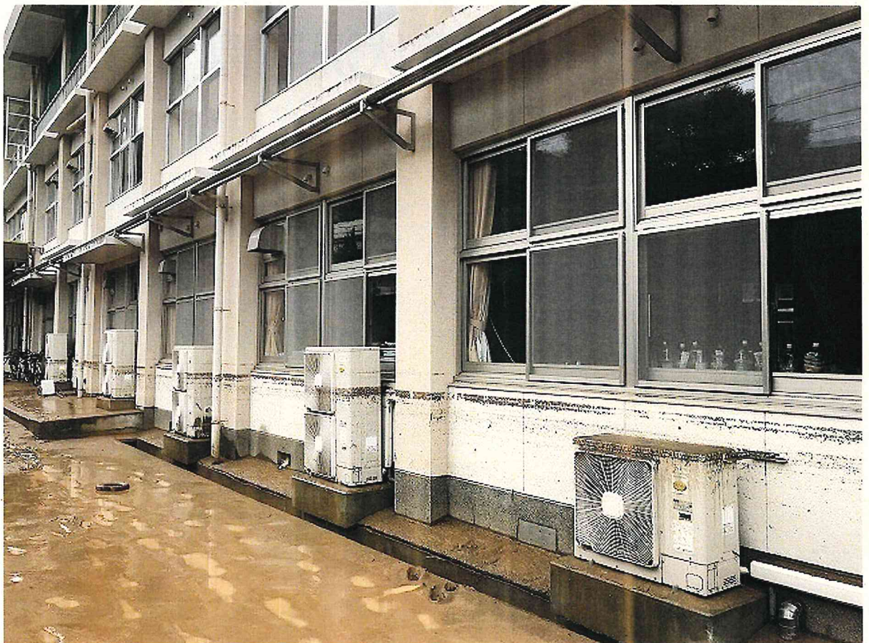
室外機上まで冠水
