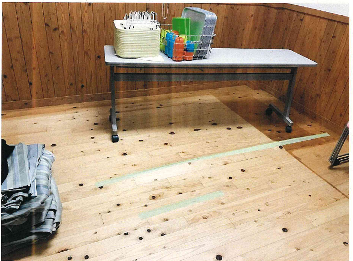
面談室床に浮き発生（1週間後）
