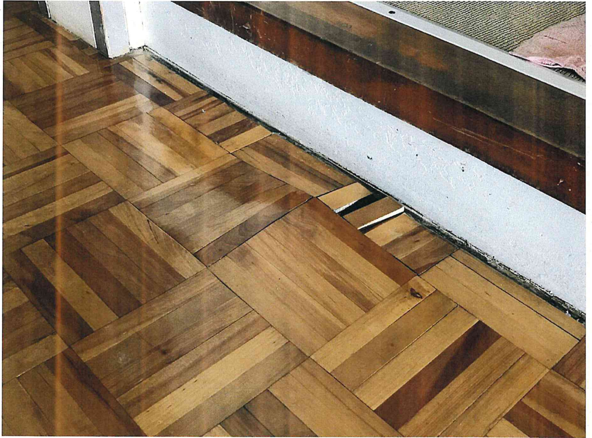
管理棟廊下浮き（1週間後）
