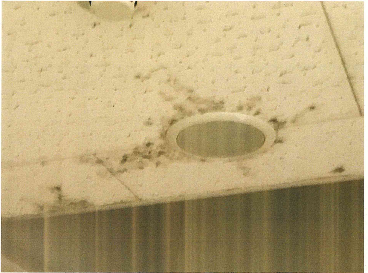
高等部棟廊下天井にカビ発生
