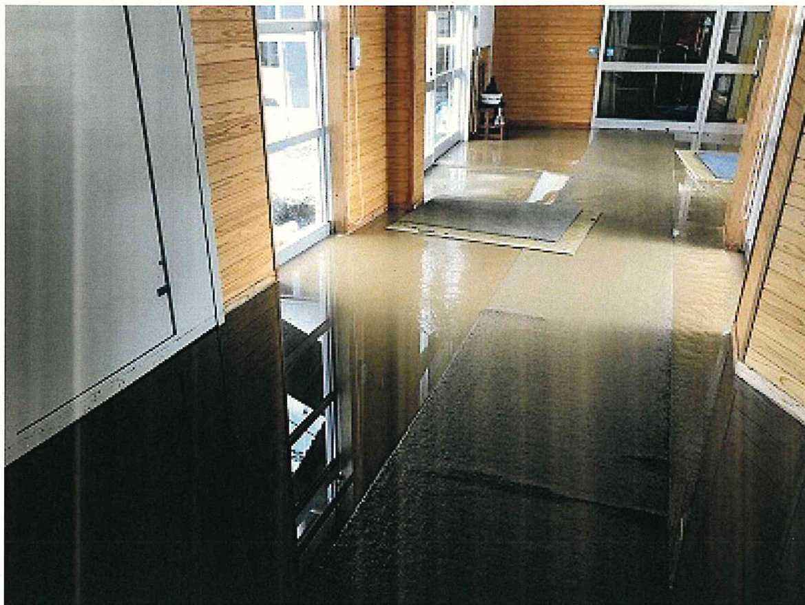
渡り廊下（最深8cm冠水）
