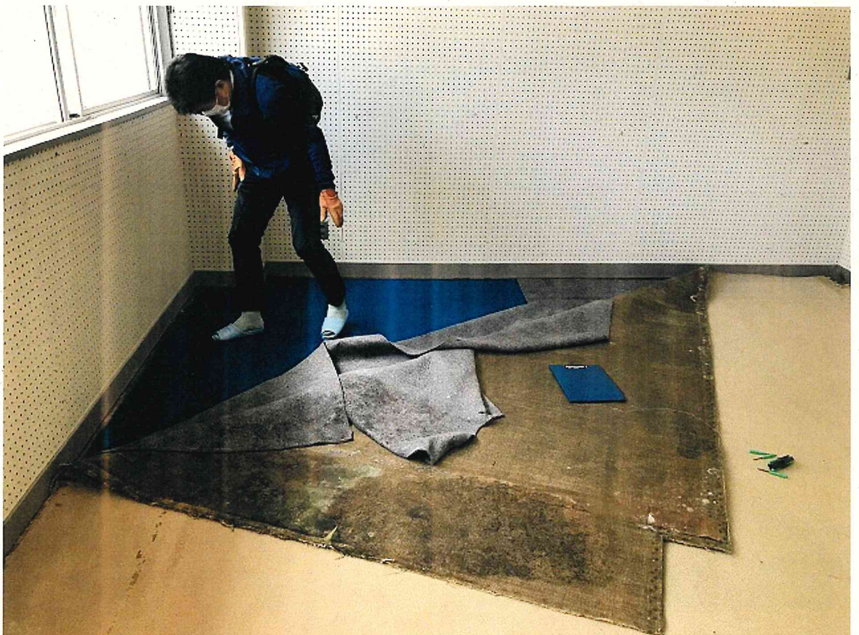
床カーペット一面にカビ発生（7月17日の様子）
