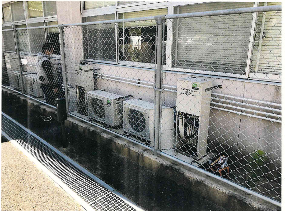
床暖房・エアコンの室外機が冠水
