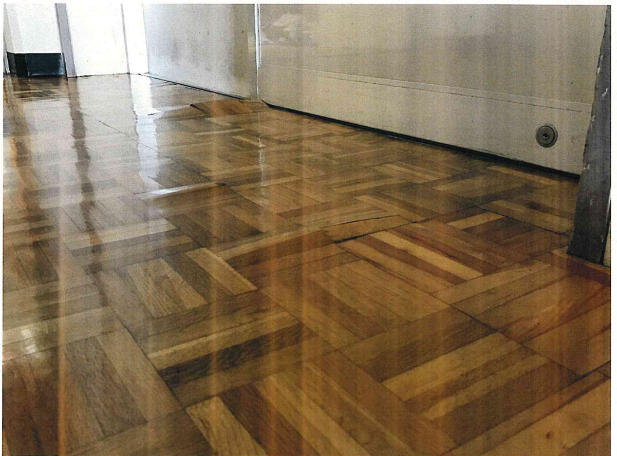
管理棟廊下浮き（1週間後）
